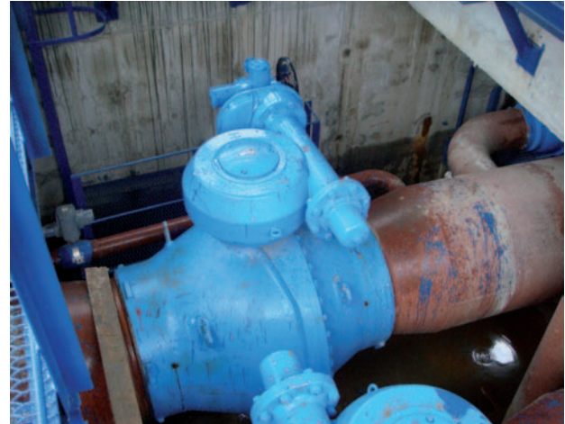
Шаровые краны Ду 1000 на теплосети в Санкт-Петербурге
