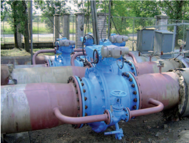
Шаровые краны КН1 на теплосети в Польше
