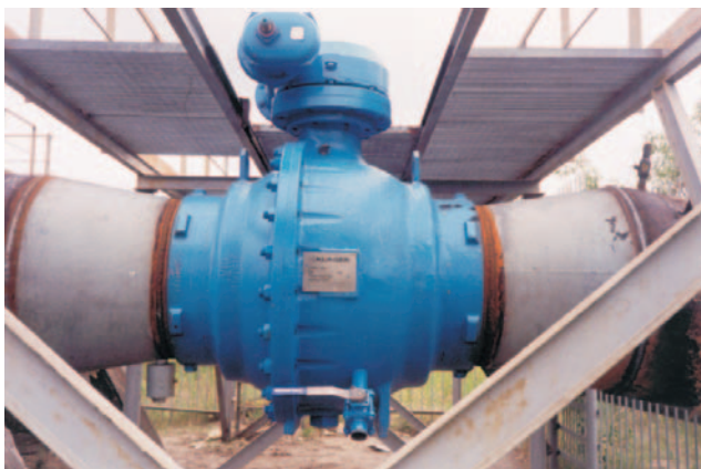
Шаровые краны «Баллостар» Ду 700, трубопровод Ду 900, горячая вода 150°C
